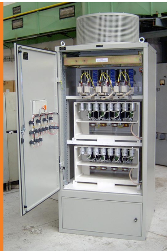
Шкаф преобразователя с силовыми составными блоками
